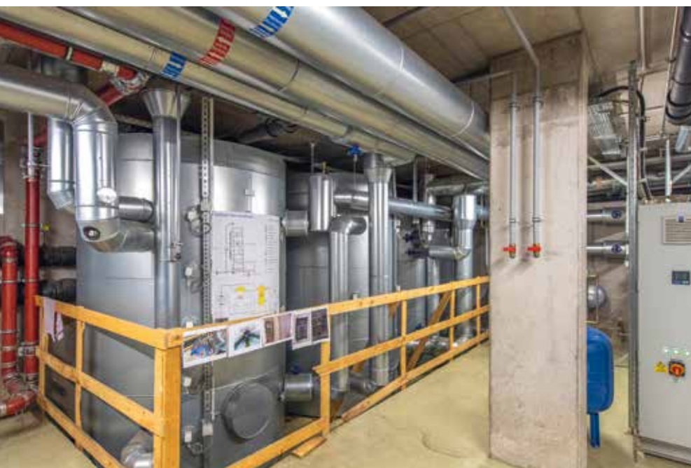
Die Technikzentrale im Keller des Gebäudes
